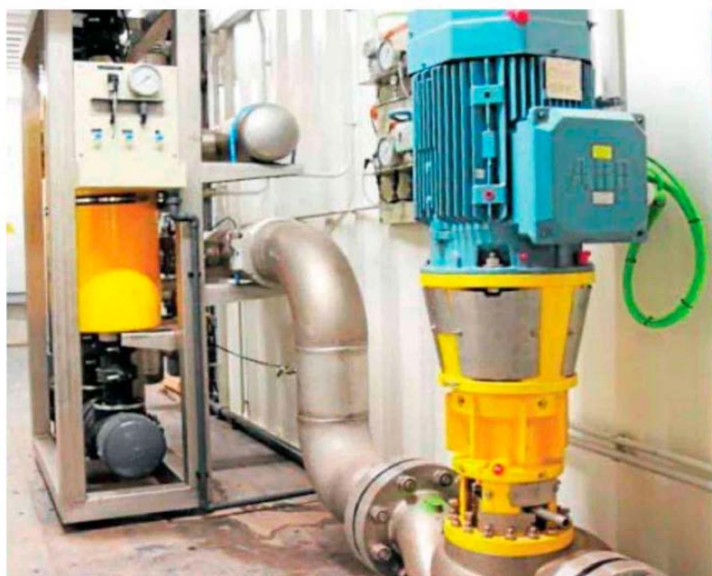
Imagen de una desaladora proyectada por el ITC dentro del proyecto Desalro 2.0. cr
